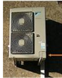
Unité extérieure sur supports muraux
