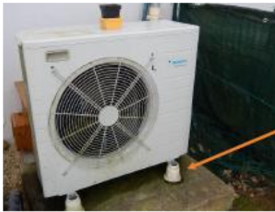
Unité extérieure sur plots antivibratiles sur massif béton
